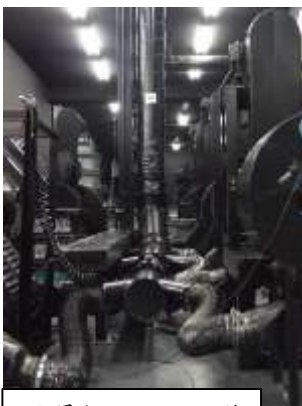
宙吊りのダクト配線
